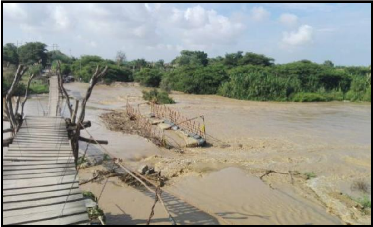
Aumento del caudal del rio Zaña y destrucción del puente.
