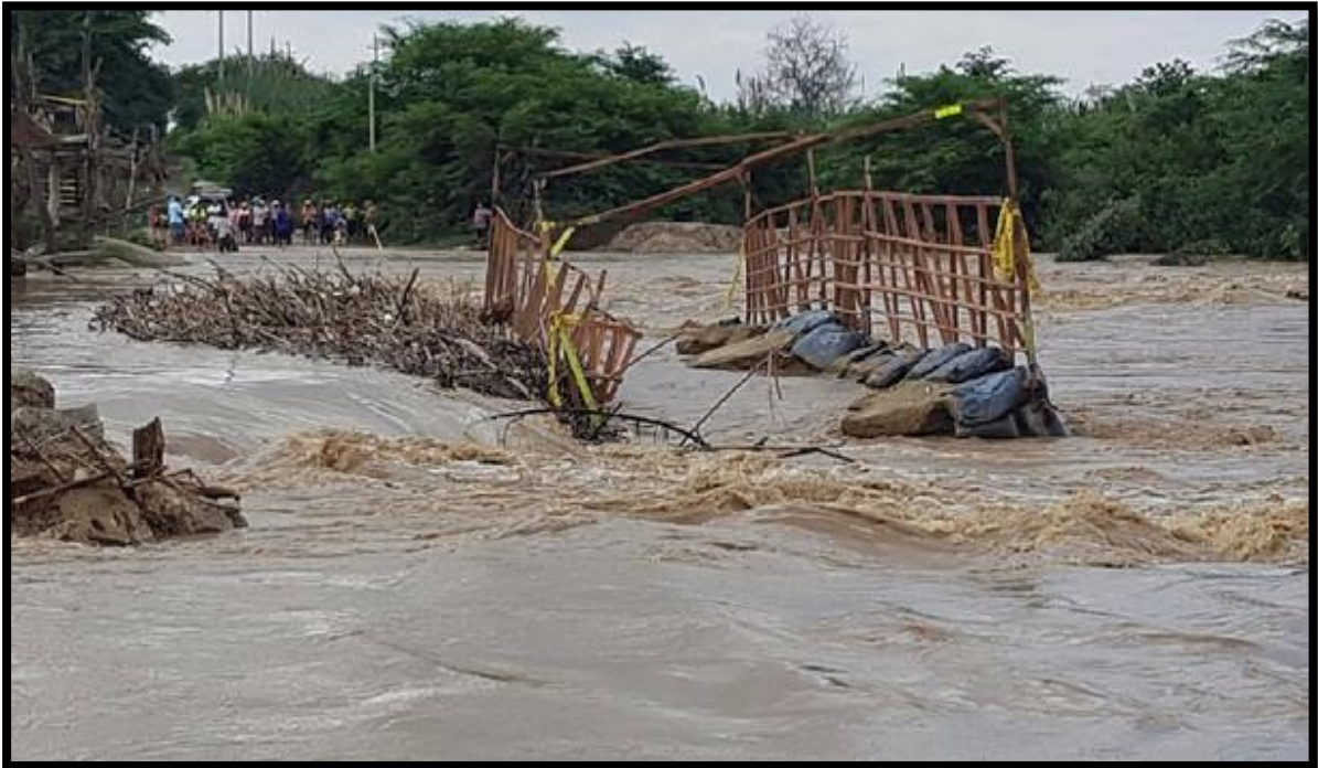
Colapso del puente por aumento del caudal rio Zaña, año 2019.
