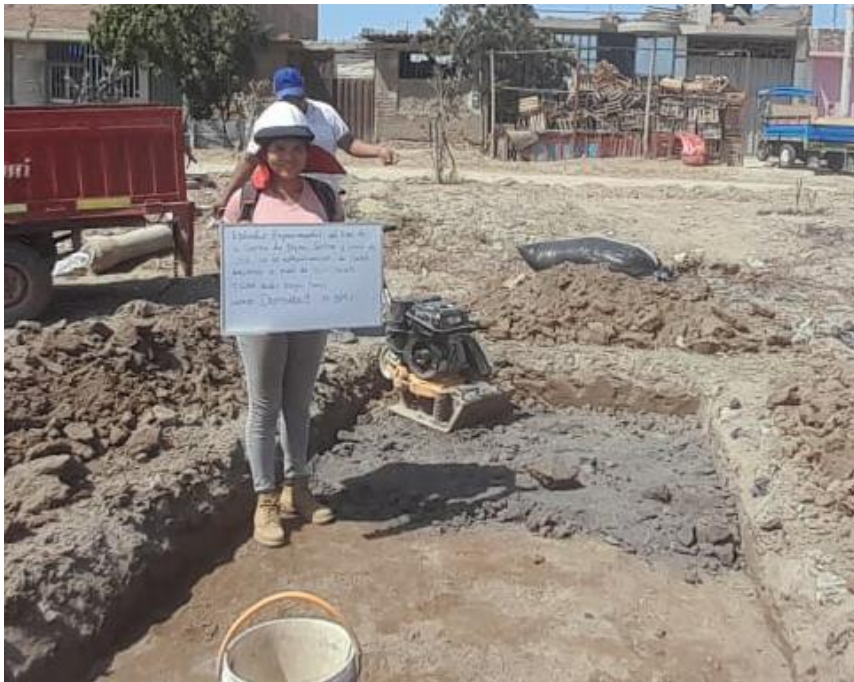
Compactación del material de la CCA y FDC con el suelo natural
