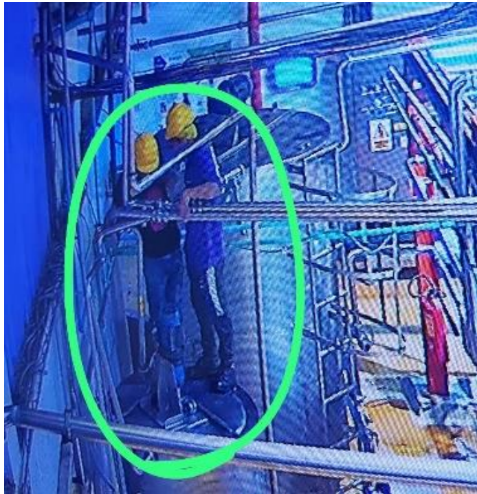
Personal operador de planta realiza trabajos no autorizados
