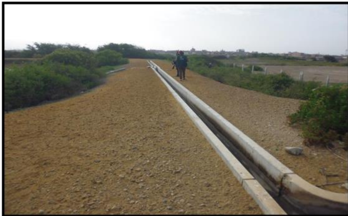
Fotografía 4: Mallas en los ramales que sirven para retener sólidos de gran tamaño llevados por la red de alcantarillado hacia la cámara de bombeo.
