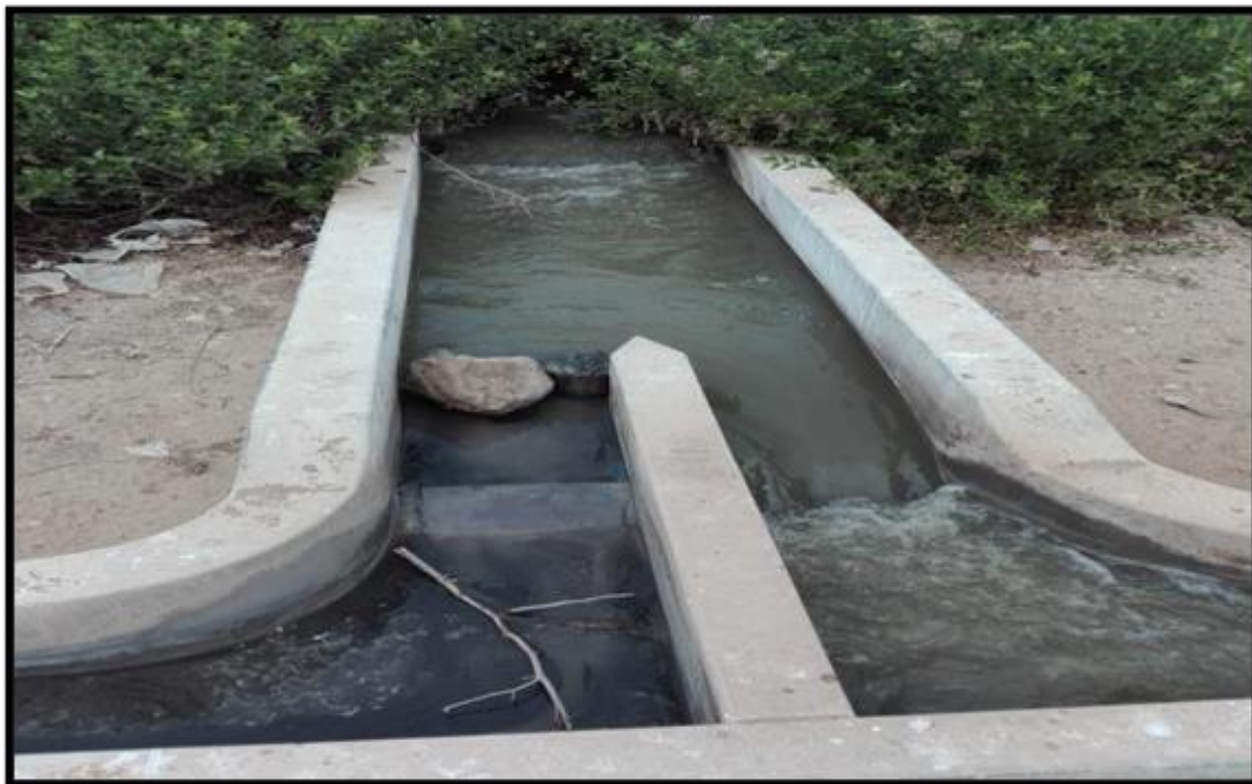
Fotografía 6: Bombeo de las aguas residuales hacia las lagunas de oxidación.
