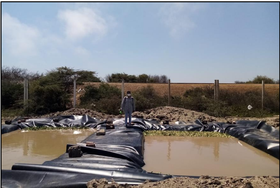
Fotografía 22: Humedales artificiales con el agua residual y las plantas acuáticas incorporadas.
