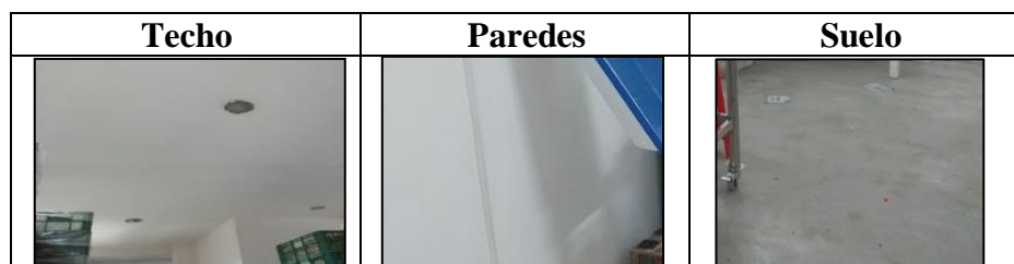
Figura 97. Colores del techo, paredes, suelo de área de horneado Fuente: Elaboración Propia.
