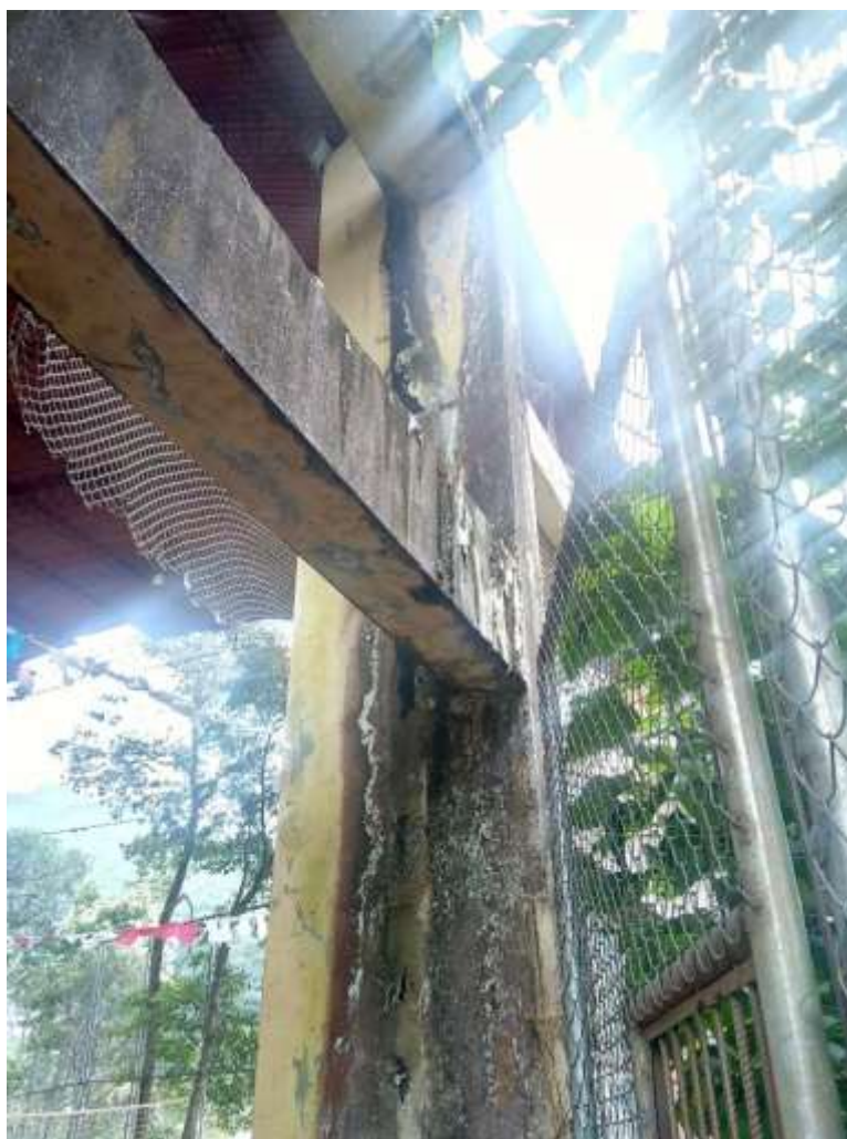
Ilustración 6: Presencia de moho en columnas y vigas. (Fuente: propia)
