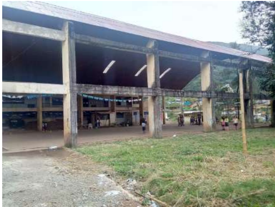
Ilustración 15: Exterior del Coliseo Cerrado Lonya Grande, con lesiones en sus estructuras y falta de aleros.
