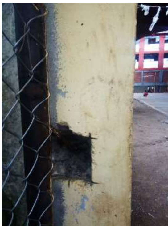
Ilustración 8: Columna con perforaciones, expuesta a minerales ambientales dañinos.. (Fuente: propia)
