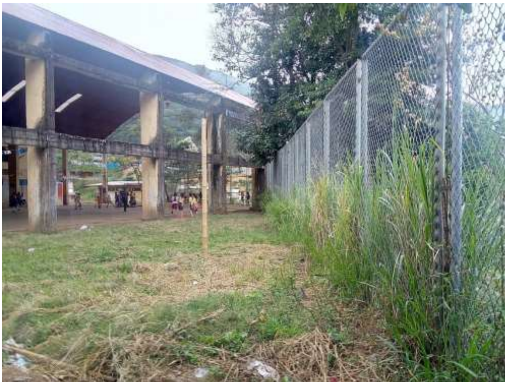
Ilustración 1: Actual estado del Coliseo Cerrado Lonya Grande con lesiones notorias en su estructura. (Fuente: Propia)
