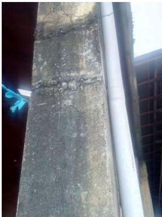
Ilustración 7: conexión de columna y viga con grietas y fisuras. (Fuente: Propia).
