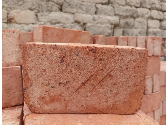
Ilustración 79: Condición entera de un ladrillo artesanal
