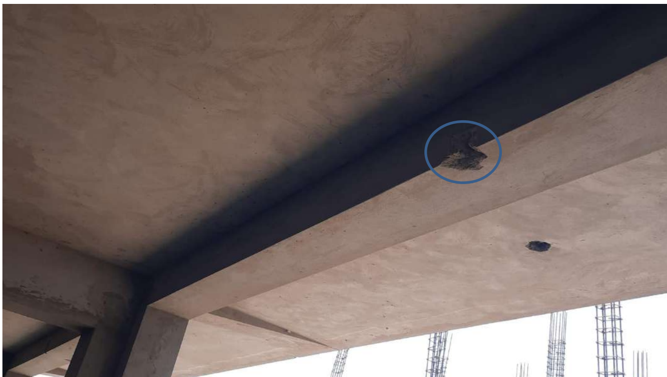
Imagen 3: Cangrejera en una viga, L=7.0m.
