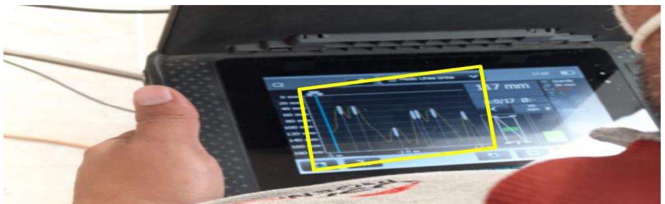
Imagen 29: El equipo realiza varios escaneos tratando de identificar el acero de la columna EJE F 1-
