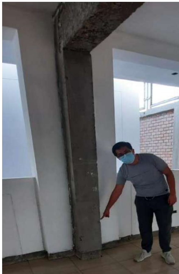
Imagen 19: Vista de un mal acabado de columna Tee Pabellón B-B.
