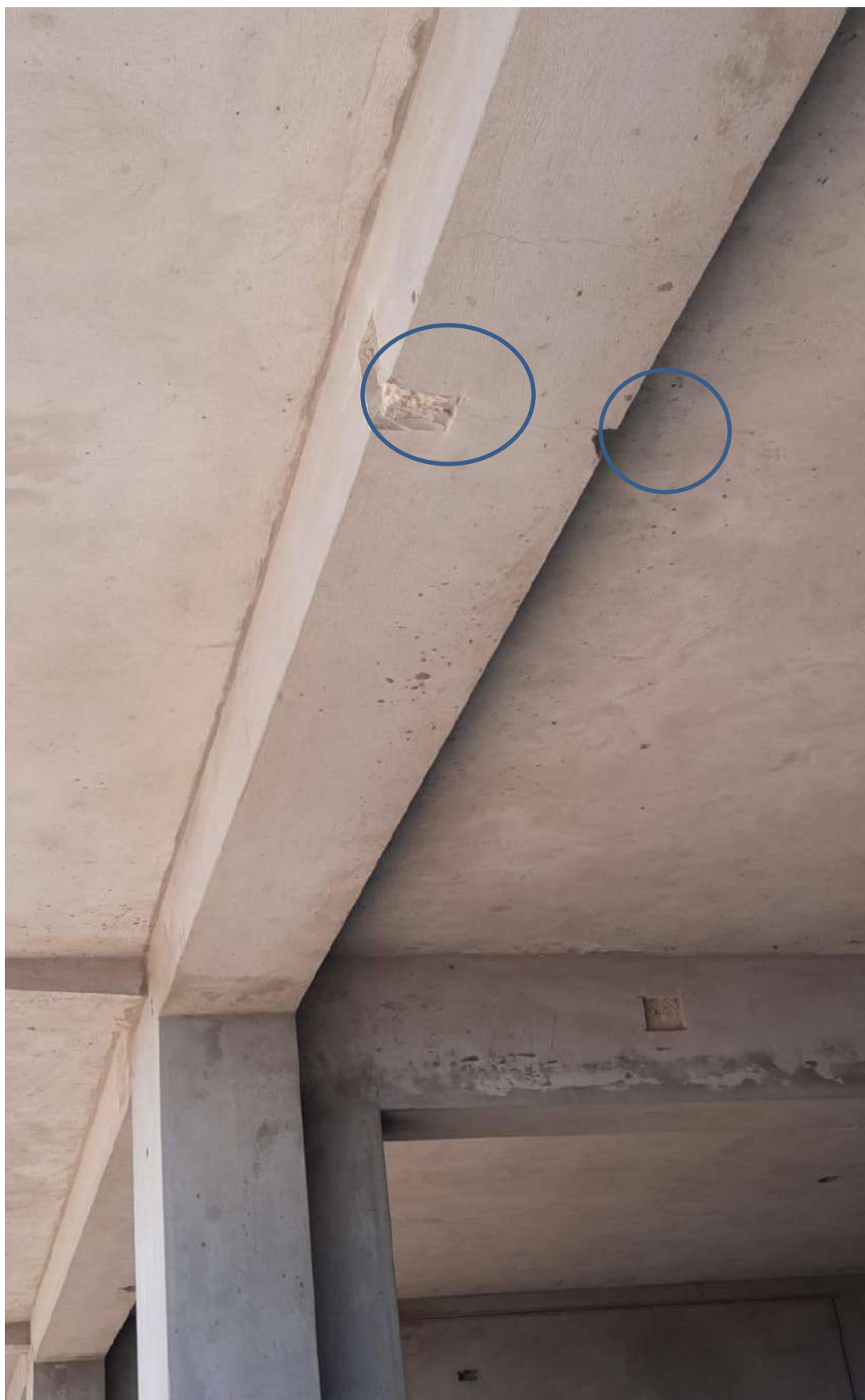
Imagen 4: Cangrejas en ambos lados de una viga de L=7.0\text{m} .
