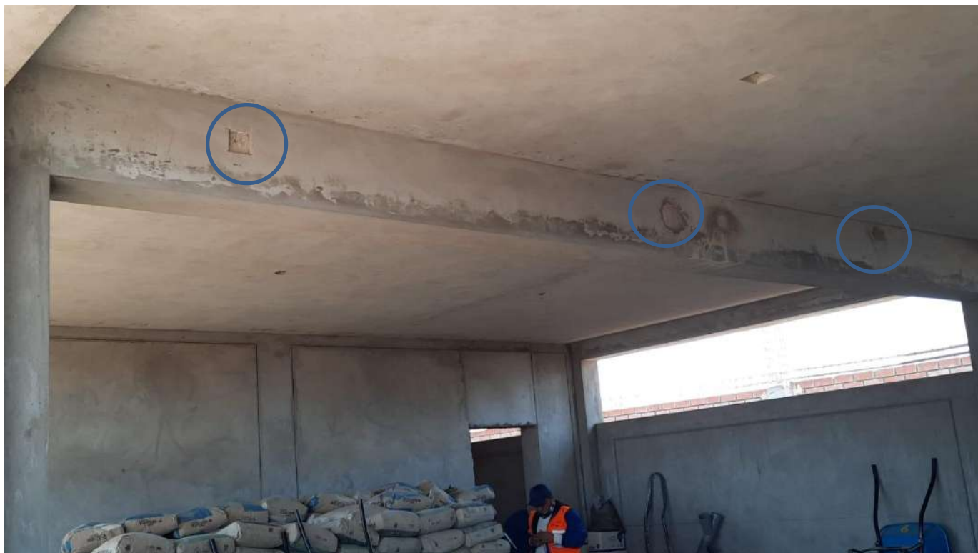
Imagen 2: Aparición de cangrejas en una de las vigas principales.
