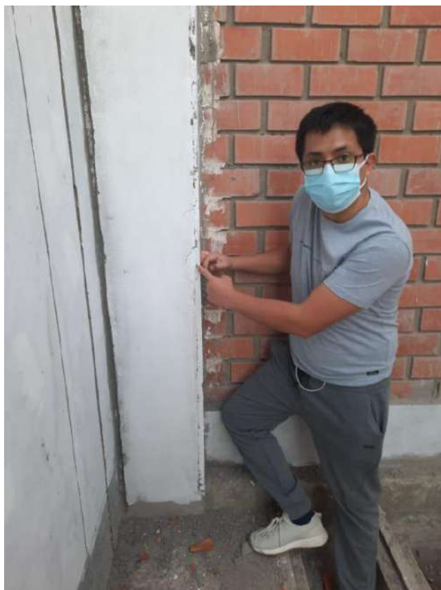
Imagen 22: Vista de un mal acabado de columna perimetral del muro perimétrico Pabellón B-B.
