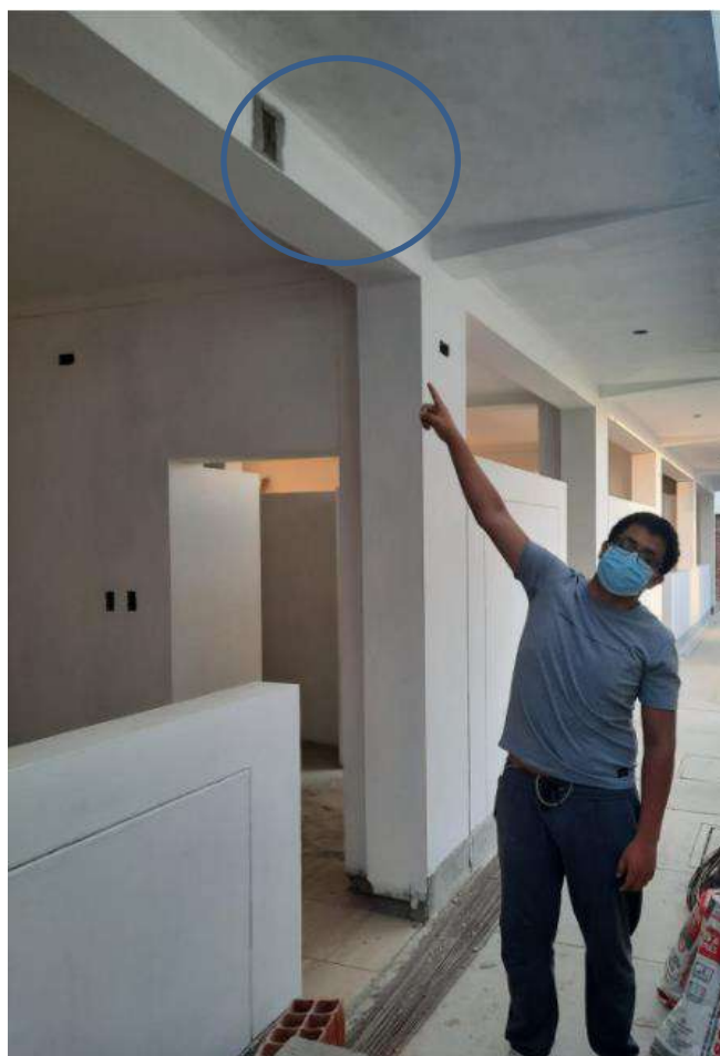
Imagen 6: Cincelado para verificar la profundidad de la fisura que es de 0.5\text{mm} de una viga principal.
