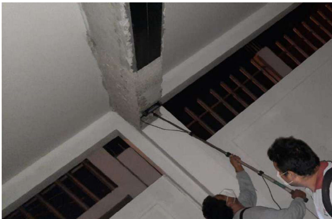
Imagen 42: Escaneo del diámetro del estribo de la viga EJE 6 (se observa que hay un pedazo de madera o plástico negro pegado en la viga)
