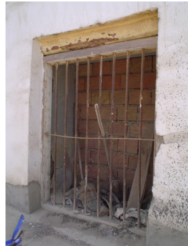
Figura 52: Corrosión de los metales
