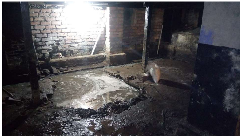
Figura 58: Parte baja del escenario presenta filtraciones, Chiclayo, 2019
