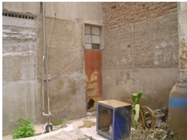
Figura 53: Aparición de plantas debido a la humedad del suelo
