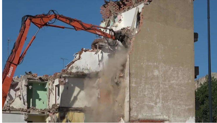
Figura 34: Lo destruido no tiene la relevancia histórica para conservarlo.
