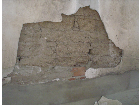
Figura 51: Desprendimiento del enchapado de yeso
