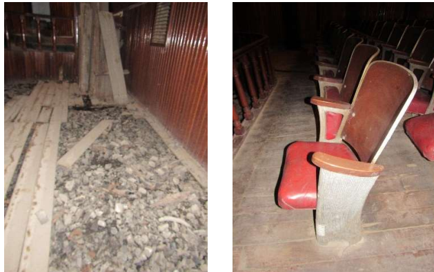
Figura 56: Lesiones varias, destruccion del piso del coro, y descuido de la zona de butacas
