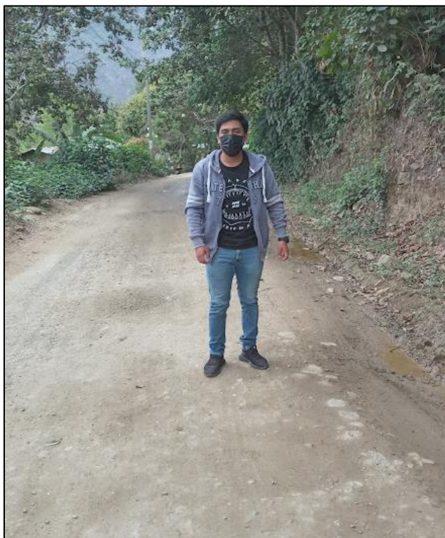
Fotografía 72. Falta de obras de drenaje en la vía existente
