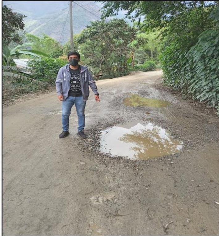
Fotografía 59. Ahuellamiento, bacheo y empozamiento de agua en Km 12+060
