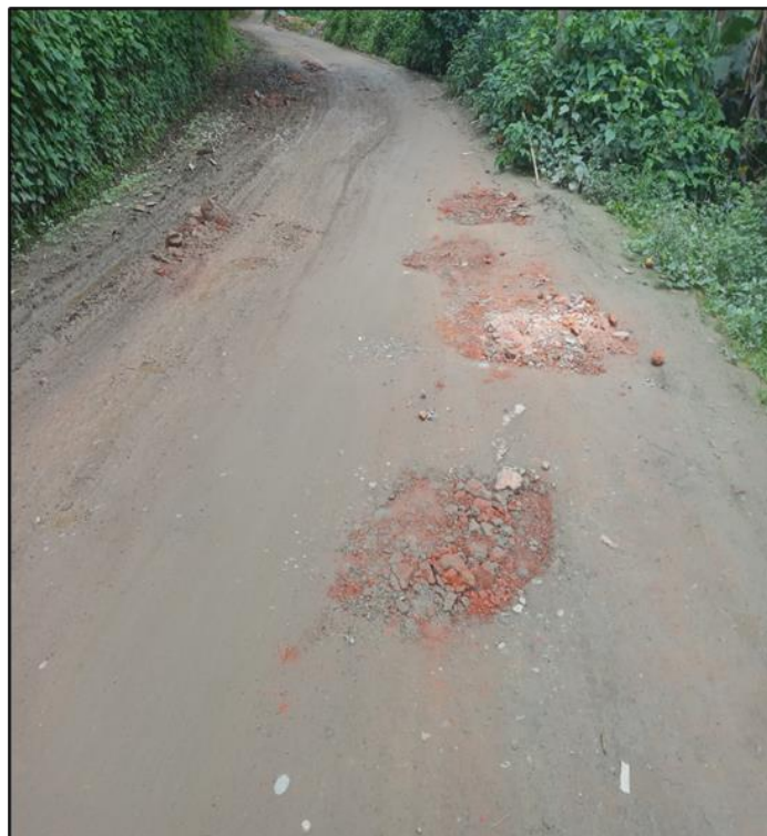
Fotografía 57. Ahuellamiento, bacheo rellenado con ladrillos en Km 3+860
