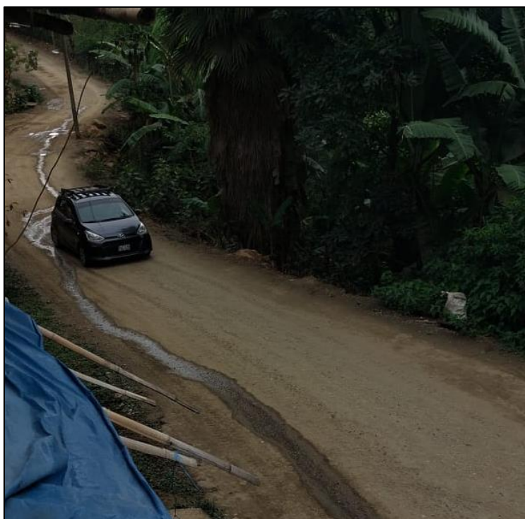
Fotografía 73. Esguerrimiento de agua por falta de drenaje en la vía existente
