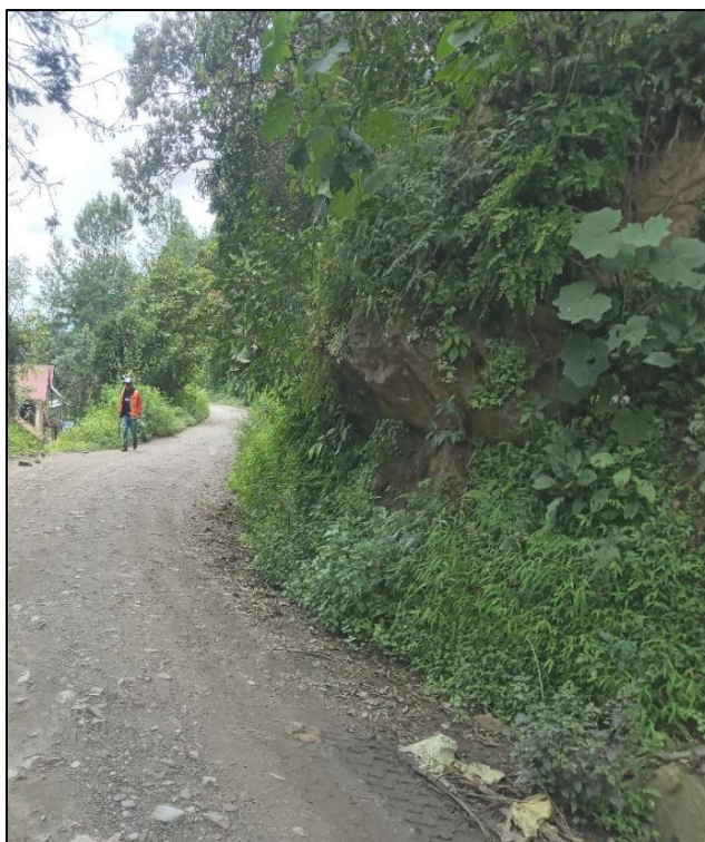
Fotografía 71. Peligro de deslizamiento en Km 9+950
