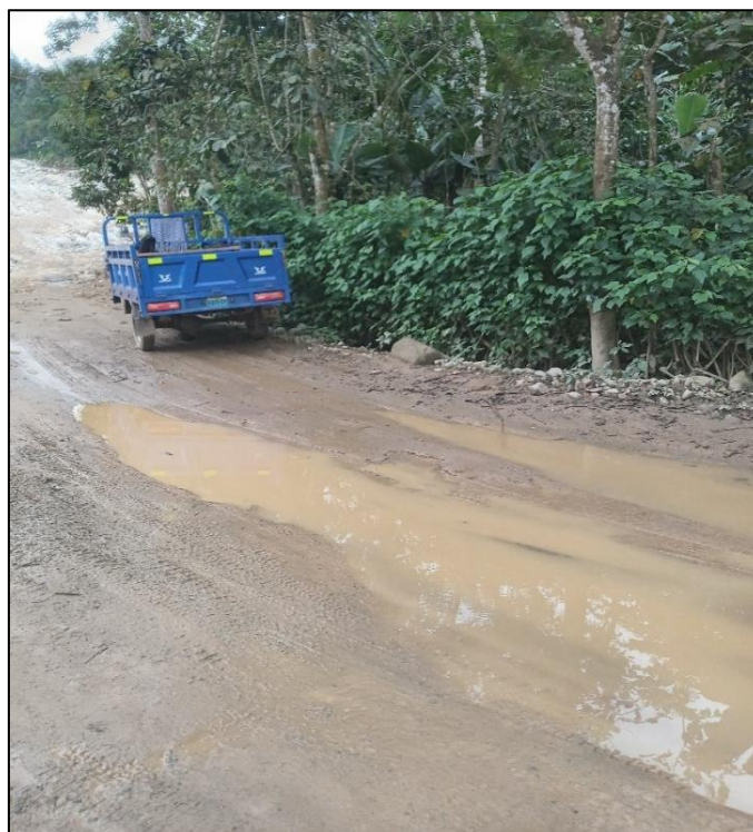
Fotografía 58. Ahuellamiento, bacheo y empozamiento de agua en Km 5+890
