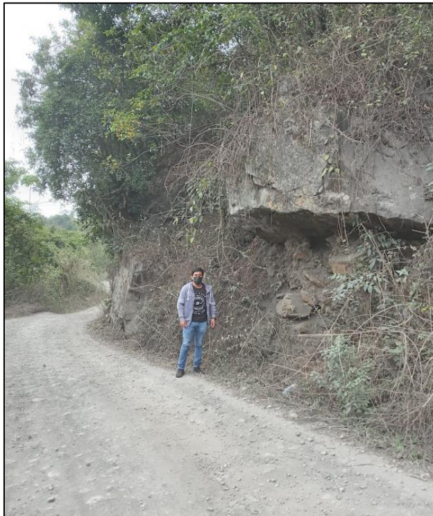
Fotografía 70. Peligro de deslizamiento de roca en Km 3+100
