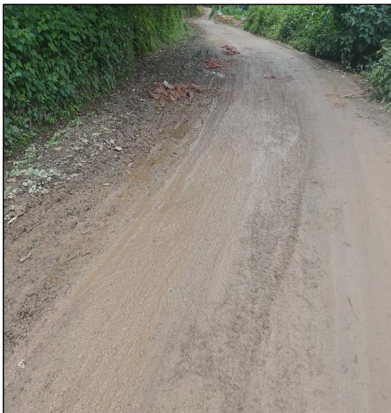
Fotografía 55. Ahuellamiento en Km 3+120
