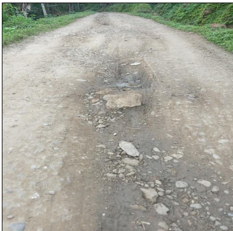
Fotografía 56. Ahuellamiento y bacheo en Km 3+280
