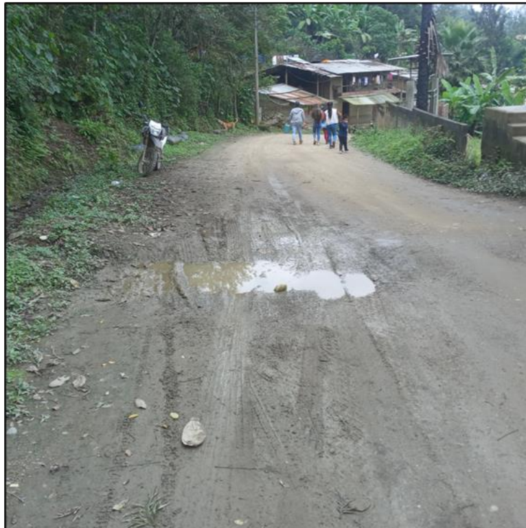
Fotografía 54. Ahuellamiento y empozamiento de agua en Km 2+190
