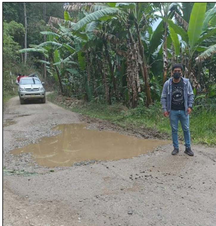
Fotografía 62. Presencia de quebrada en Km 11+260 y empozamiento de agua en la vía
