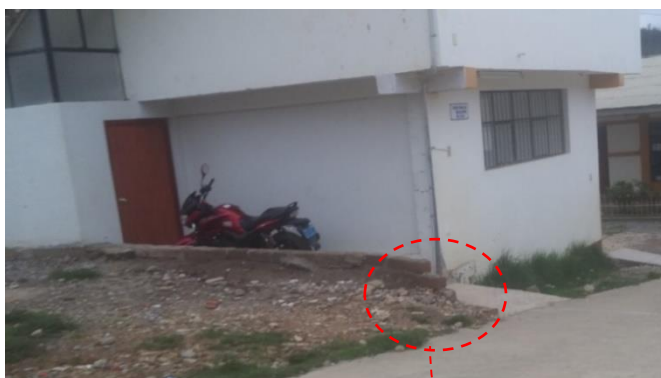
Imagen 7: Identificación de problemas estructurales
