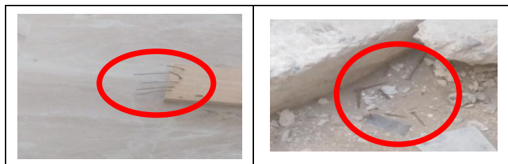
Figura 5. Elementos punzocortantes expuestos
