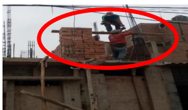
Figura 6. Trabajos en altura, sin señalización de “Caída de objetos”
