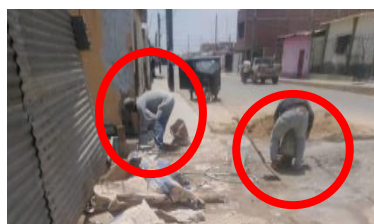
Figura 3. Exceso de peso al cargar mezcla de concreto
