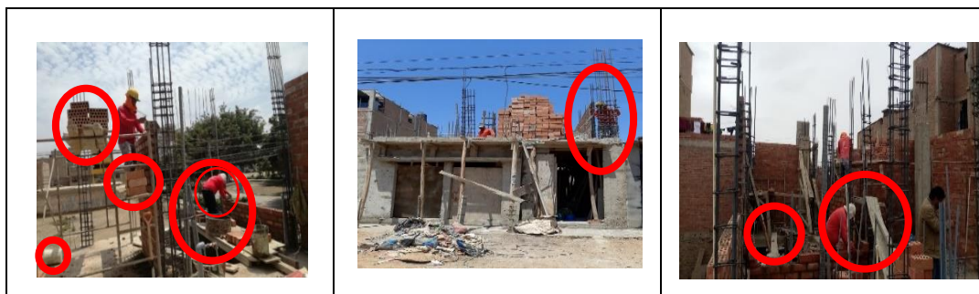
Figura 2. Actividades de construcción sin EPP y sin EPC
