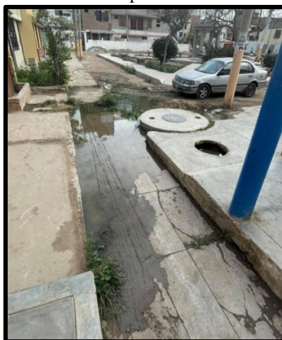
Imagen N° 03. Buzón colapsado en la calle M. Rodríguez
