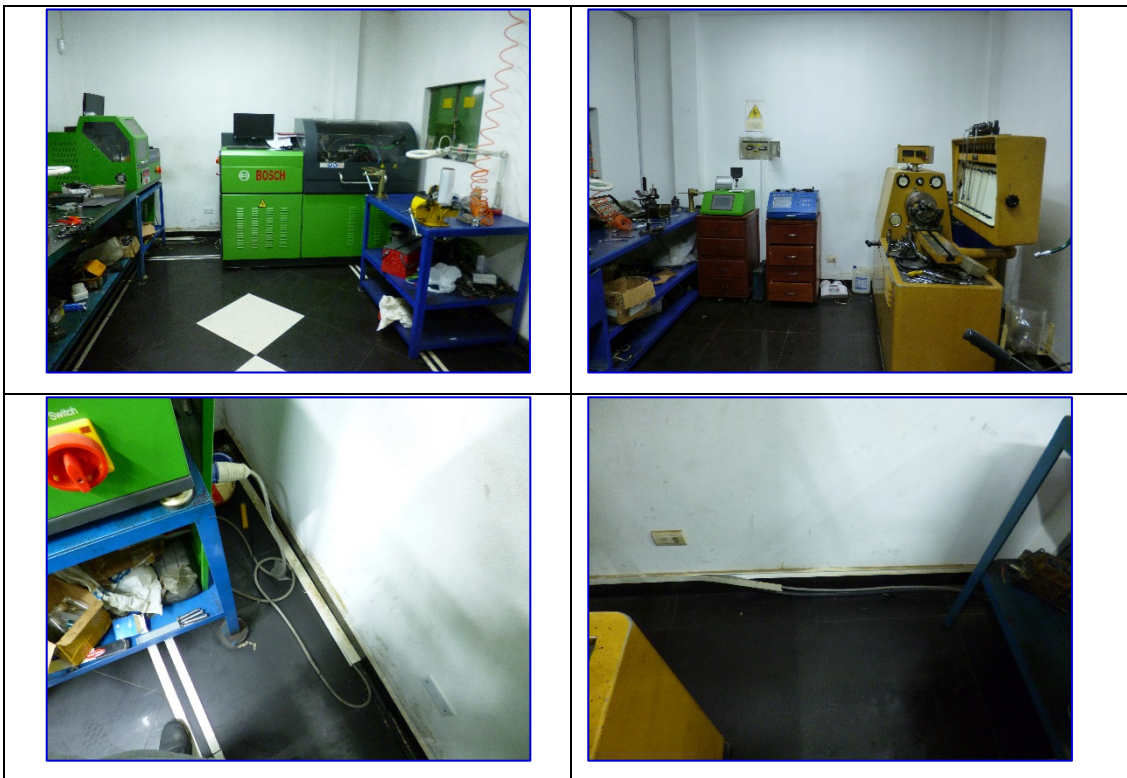
CUARTO DE MÁQUINAS
