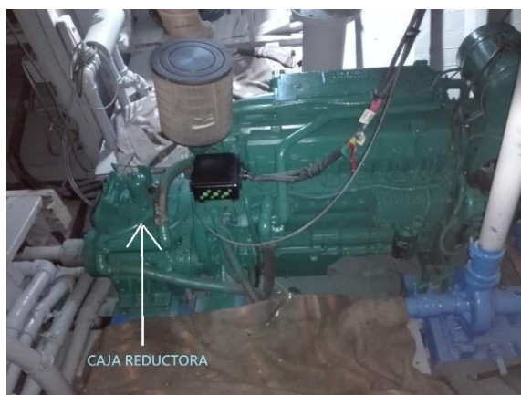
Figura 13: Caja reductora del motor vista interiormente.
