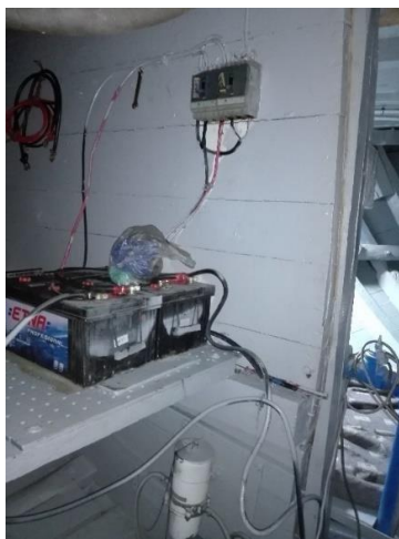
Figura 16: Acumulador de energía
