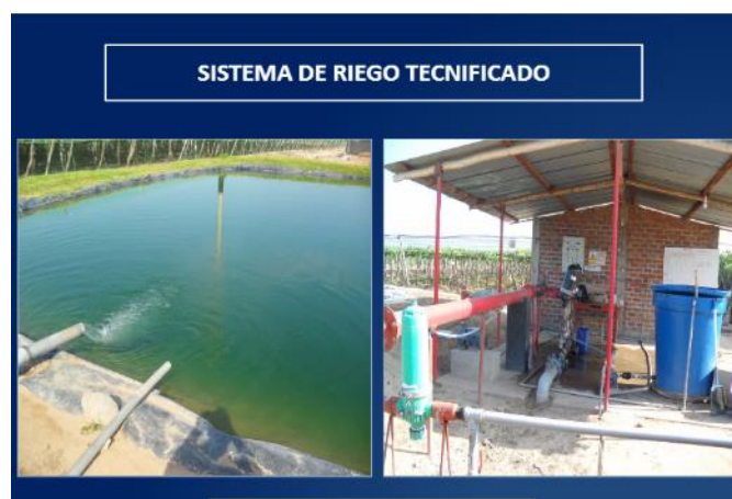
Figura 17: Sistema de riego tecnificado
