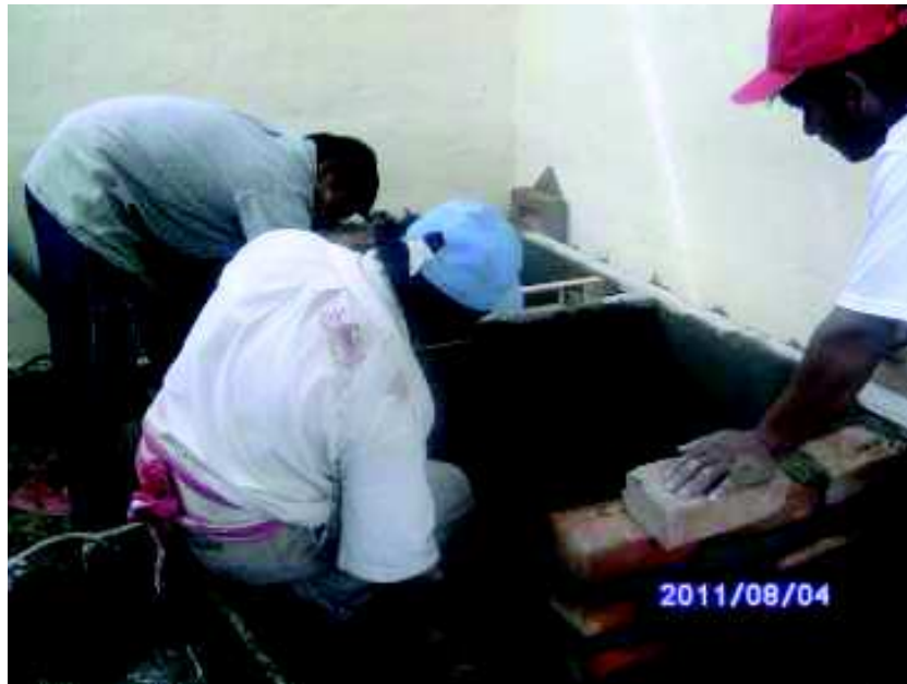
FOTOS 17 y 18: Dentro del desarrollo del Plan de Acciones se viene realizando el mejoramiento de la vivienda y la construcción de la cocina mejorada permitiendo mejorar las condiciones de vida de las familias beneficiarias del proyecto.
