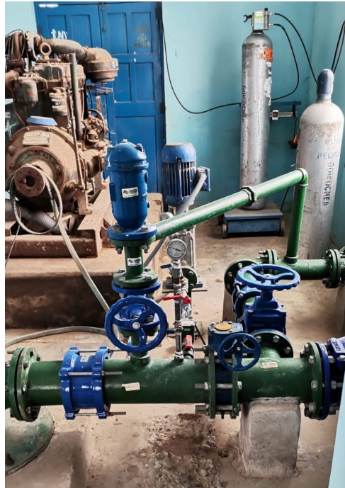
Imagen N° 07: Tratamiento de agua en la estación de bombeo
