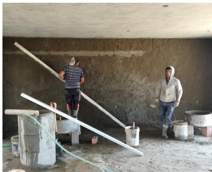
Figura 106 Trabajo Productivo en la Partida de Tarrajeo de Muros Fuente: Elaboración propia
