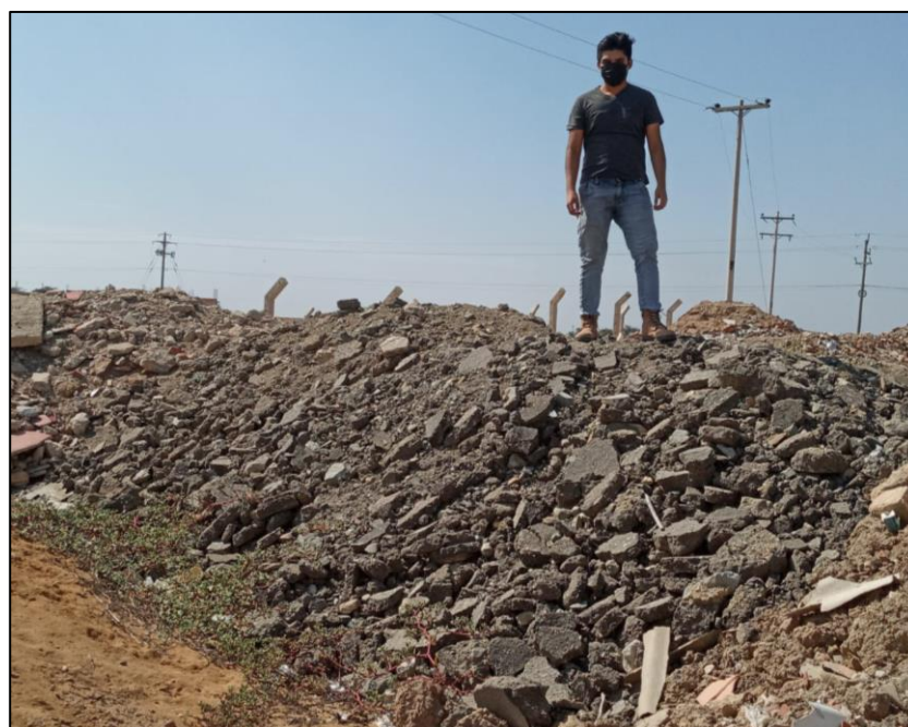
Ilustración N°4.2: Acumulación de carpeta asfáltica en carretera San José – Salida Ciudad de Dios. Fuente: Propia
