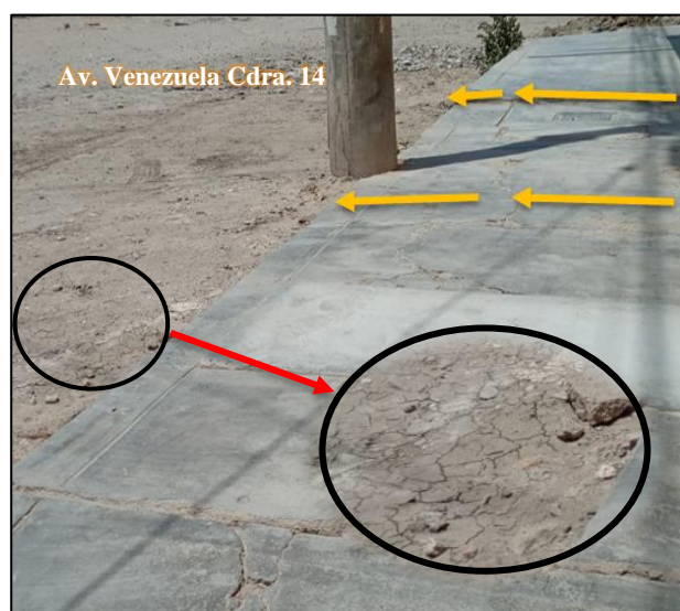
Figura 4: Asentamiento en veredas e indicios de arcillas expansivas en Av. Venezuela cdra. 14.
