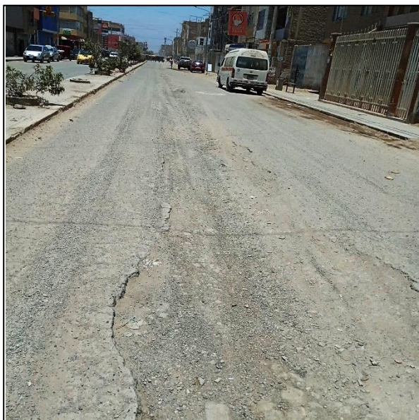
Figura 1: Pavimento defectuoso en Av. México cdra. 04. Fuente: Propia
