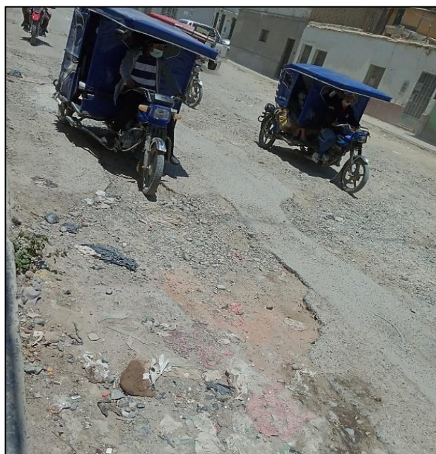
Figura 2: Pavimento defectuoso en Av. El dorado cdra. 08. Fuente: Propia
