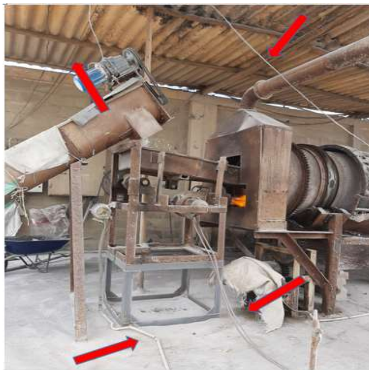
Figura 163. Cables de electricidad en el aire en el proceso de secado.
