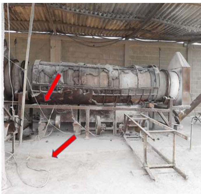
Figura 164. Cables de electricidad en el área de sacado en el piso.
