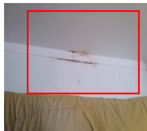
EXPOSICIÓN AGENTES EXTERNOS Y DAÑO POR HUMEDAD EN VIGA 3V-3
