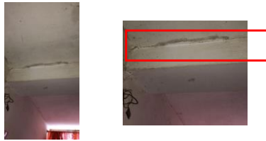
EXPOSICIÓN AGENTES EXTERNOS Y DAÑO POR HUMEDAD EN VIGA 1V-2
