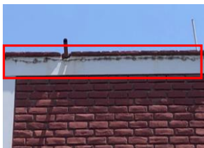
GRIETAS EN VIGA 4VA-1
