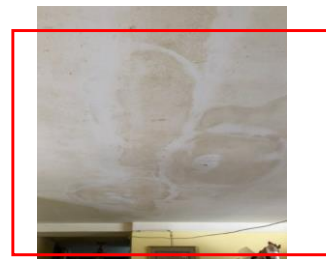
DAÑO POR HUMEDAD EN LA VIGA 1VA-2
