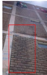
DAÑO POR HUMEDAD Y DETERIORO EN VIGA 2VA-1
