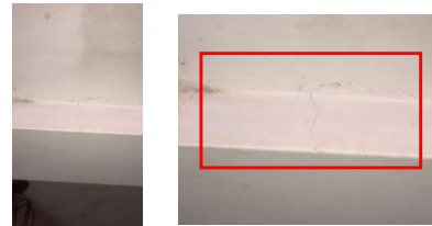
FISURA EN VIGA 1V-3
