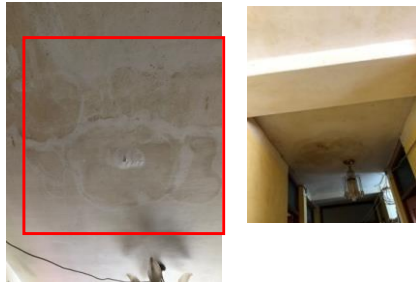
DAÑO POR HUMEDAD EN LOSA
