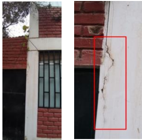
GRIETA EN COLUMNA D-3
