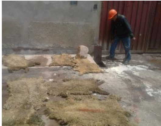
3-Colapso de alcantarillado
