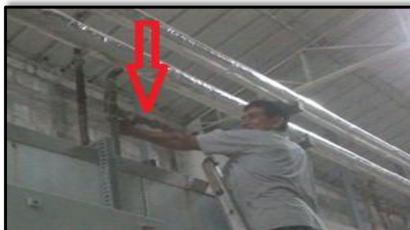
Figura 25: Manipulación de válvula de agua caliente
