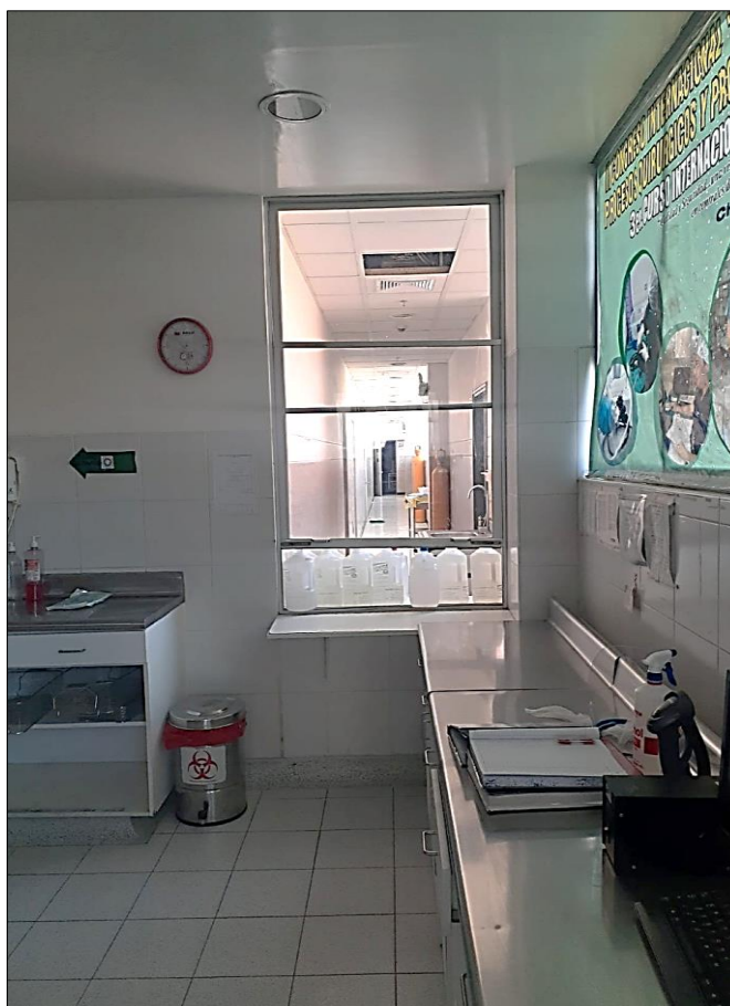
Figura 16. Imagen de una de las ventanas del servicio de central de esterilización en mal estado. Nótese que se ha buscado bloquear la caída de la ventana con galoneras de plástico
