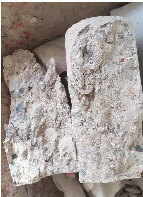
Imagen 21 Percepción visual para el análisis de segregación en el concreto
