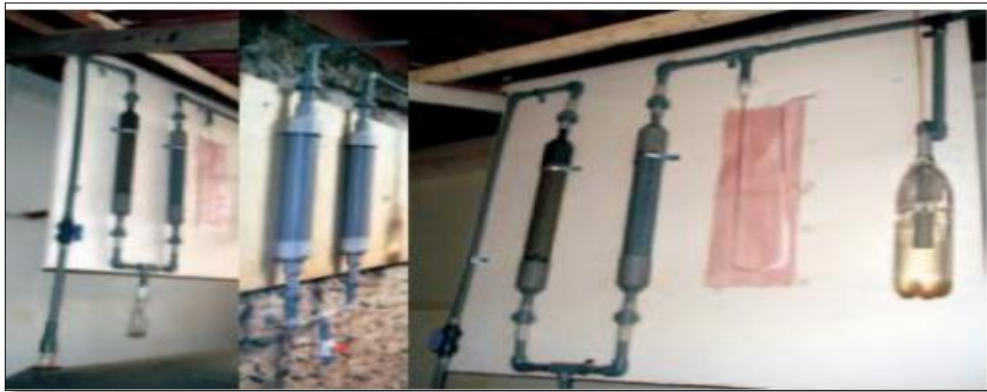
Figura 7. Sistema de eliminación de agua para medir y controlar de presión
