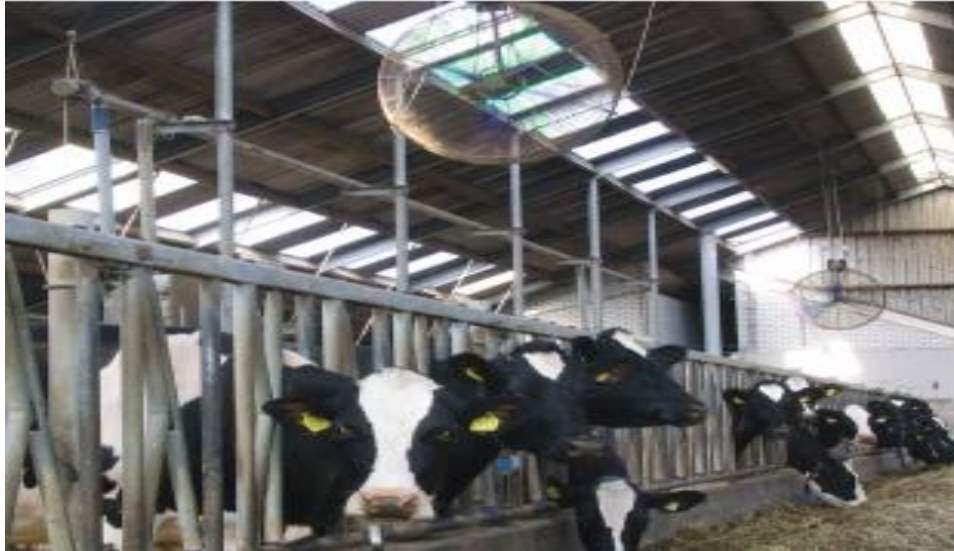
Figura 10. Ventiladores para establos de techos bajos
