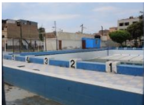
Imagen n°93 Zona de piscina en mal estado/ Fuente: Elaboración Propia
