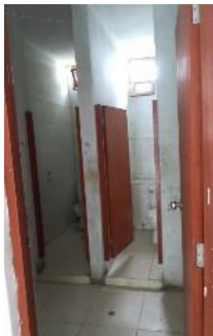
Imagen n°72 Fisuras en pisos- Bloque B CCI-GBA/ Fuente: Elaboración Propia
