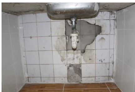
Imagen n°78 Ruptura de cerámicas y mobiliarios en mal estado Bloque D CCJ-GBA/ Fuente: Elaboración Propia
