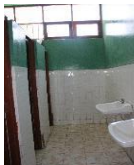
Imagen n°60 Fisuras en zócalos - Bloque A CCJ-GBA/ Fuente: Elaboración Propia
