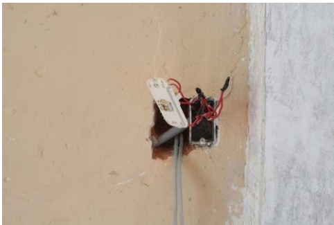
Imagen n°19 Lesiones en Inst. Eléctricas CCJ - GBA Fuente: Elaboración propia
