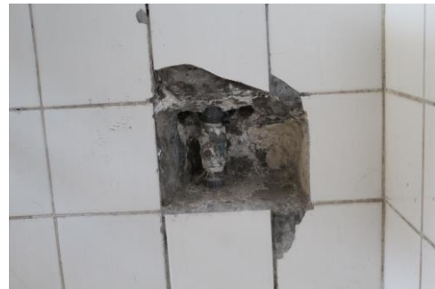
Imagen n°20 Lesiones en Inst. Sanitarias CCJ - GBA Fuente: Elaboración propia
