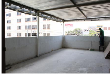
Imagen n°64 Desprendimiento de contrazócalos - Bloque A CCJ-GBA/ Fuente: Elaboración Propia
