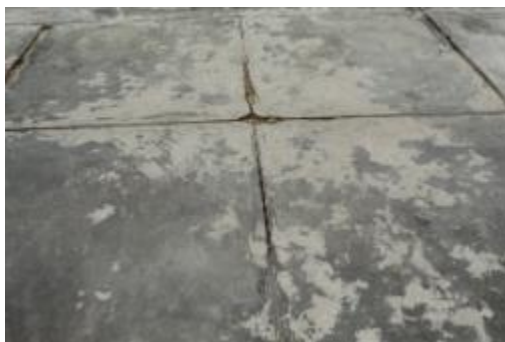
Imagen n°13 Eflorescencias- Ambiente exterior GBA-CCJ/ Fuente: Elaboración Propia
