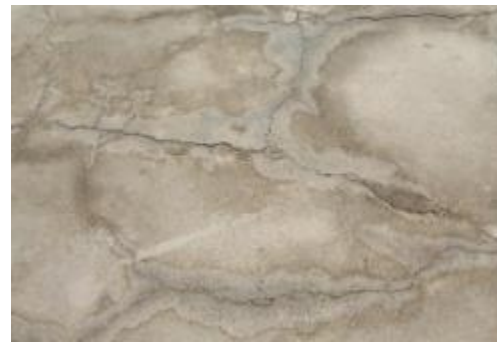
Imagen n°14 Hongos - Ambiente exterior GBA-CCJ/ Fuente: Elaboración Propia
