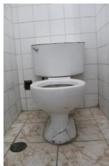
Imagen n°66 Fisuras en su mobiliario - Bloque A CCJ-GBA/ Fuente: Elaboración Propia
