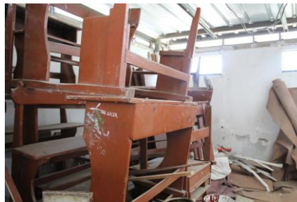
Imagen n°65 Ruptura de planchas de drywall - Bloque A CCJ-GBA/ Fuente: Elaboración Propia
