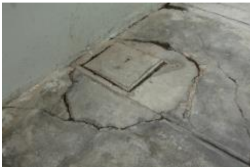
Imagen n°11 Grietas- Ambiente exterior GBA-CCJ/ Fuente: Elaboración Propia
