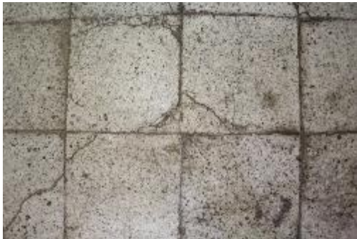
Imagen n°15 Fisuras y manchas en pisos CCJ - GBA Fuente: Elaboración propia
