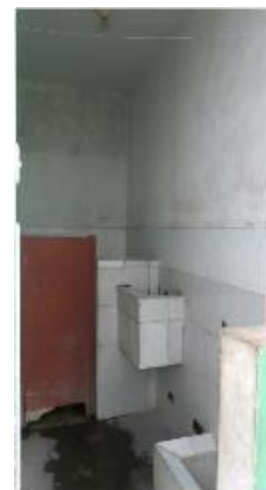
Imagen n°70 SS. HH mal estado - Bloque B CCI-GBA/ Fuente: Elaboración Propia
