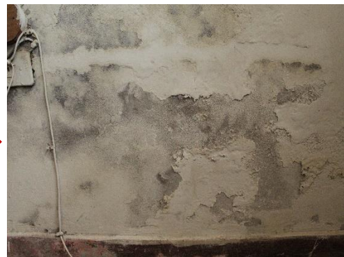
Imagen n°28 Eflorescencias en muros CCJ - GBA Fuente: Elaboración propia
