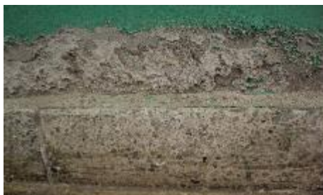
Imagen n°58 Descascaramiento en muros - Bloque A CCJ-GBA/ Fuente: Elaboración Propia
