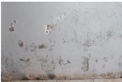
Imagen n°17 Manchas en revestimientos CCJ - GBA Fuente: Elaboración propia
