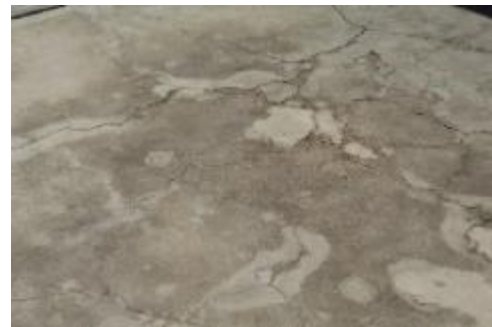
Imagen n°12 Fisuras - Ambiente exterior GBA-CCJ/ Fuente: Elaboración Propia
