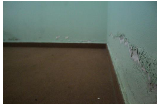
Imagen n°16 Descascaramientos y eflorescencias CCJ-GBA Fuente: Elaboración propia
