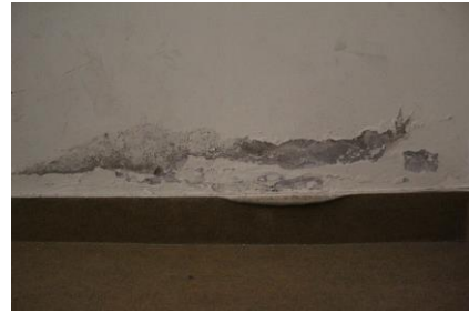
Imagen n°61 humedad en enlucidos - Bloque A CCI-GBA/ Fuente: Elaboración Propia
