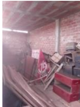
Imagen n°110 ambientes en mal estado(almacén) / Fuente: Elaboración Propia
