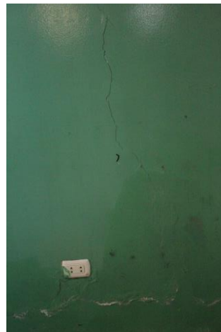
Imagen n°18 Fisuras en revestimientos CCJ - GBA Fuente: Elaboración propia
