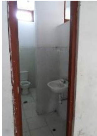
Imagen n°71 Humedad y hongos en zócalos - Bloque B CCI-GBA/ Fuente: Elaboración Propia
