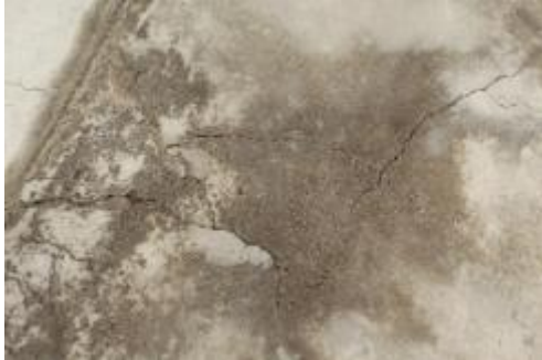
Imagen n°09 Humedad- Ambiente exterior GBA-CCJ/ Fuente: Elaboración Propia
