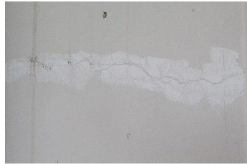
Imagen n°26 Fisuras en muros CCJ - GBA Fuente: Elaboración propia
