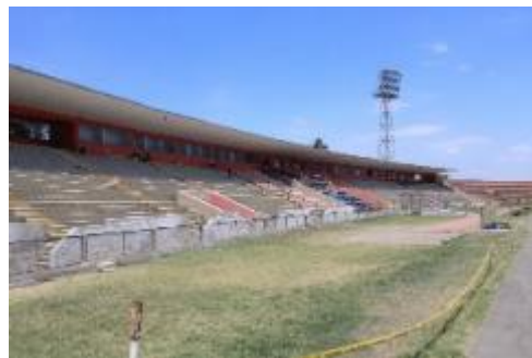
Imagen n°112 Tribunas del estadio en mal estado / Fuente: Elaboración Propia
