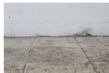
Imagen n°63 Humedad en mayólicas de piso - Bloque A CCI-GBA/ Fuente: Elaboración Propia
