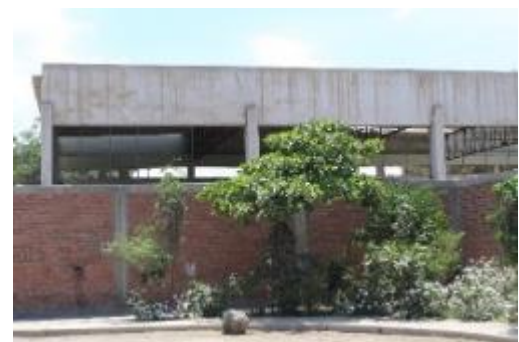
Imagen n°106 Estructura en mal estado / Fuente: Elaboración Propia
