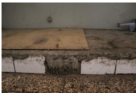
Imagen n°79 Grietas y hongos en zócalos – Bloque E CCJ-GBA/ Fuente: Elaboración Propia
