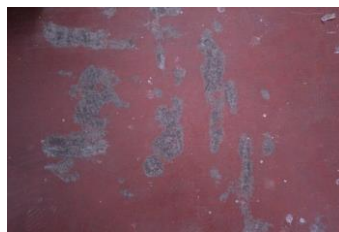
Imagen n°81 Erosiones en los pisos – Bloque D CCJ-GBA/ Fuente: Elaboración Propia
