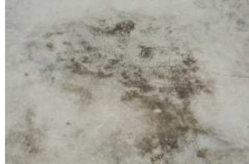
Imagen n°10 Erosión- Ambiente exterior GBA-CCJ/ Fuente: Elaboración Propia
