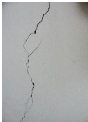
Imagen n°59 Fisuras en muros - Bloque A CCJ-GBA/ Fuente: Elaboración Propia
