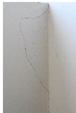
Imagen n°24 Fisuras en esquinas CCJ - GBA Fuente: Elaboración propia
