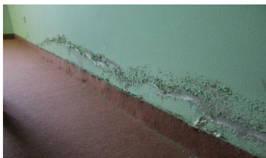
Imagen n°57 Humedad y descascaramientos – Bloque A CCI-GBA/ Fuente: Elaboración Propia
