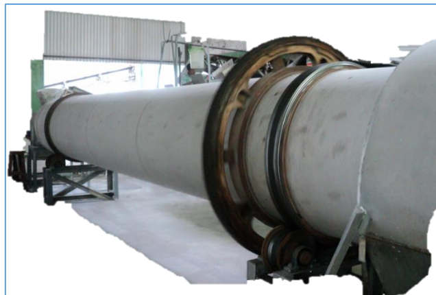
Figura 28. Cilindro de enfriamiento
