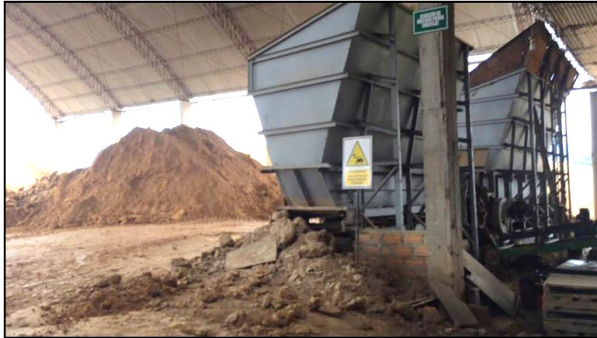
Figura 7. Tolva de recepción
