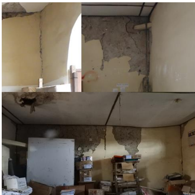
Consolidación en los muros de la fachada, que necesitan apuntalamiento.
