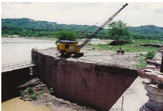
Imagen 2: Obras de Toma Directa en Río
