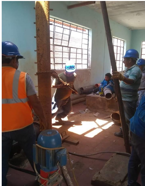
Imagen 18: Instalación de equipo de bombeo en el pozo tubular del Distrito de Jayanca
