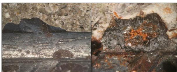
Fig. 28 Refuerzo, sin daños (izquierda) y dañado (derecha) por corrosión
