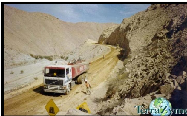
FOTOGRAFÍA N° 7.6: Cisterna conteniendo la Dosificación
