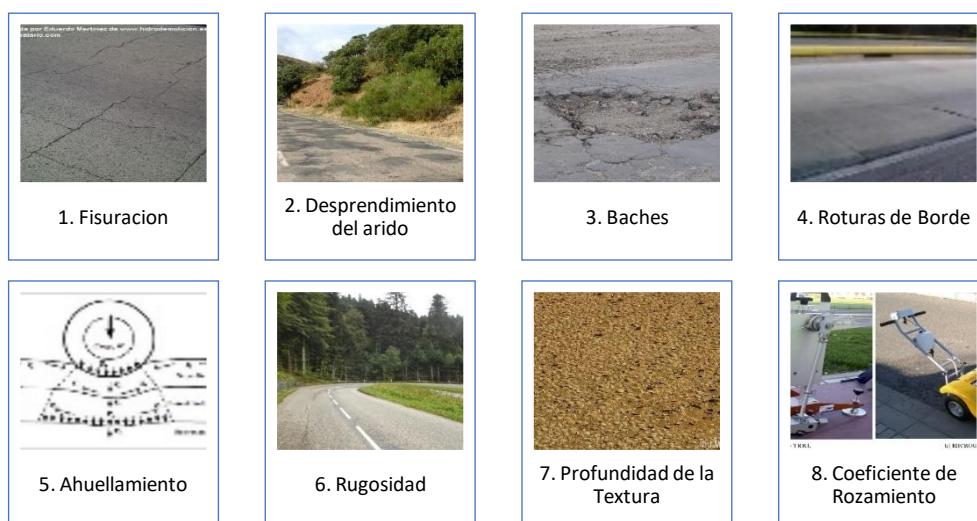
Figura 8. Modelos del deterioro del pavimento
