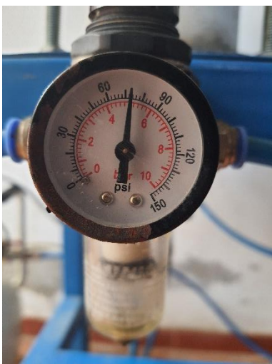
Ilustración 51: Verificación de presión
