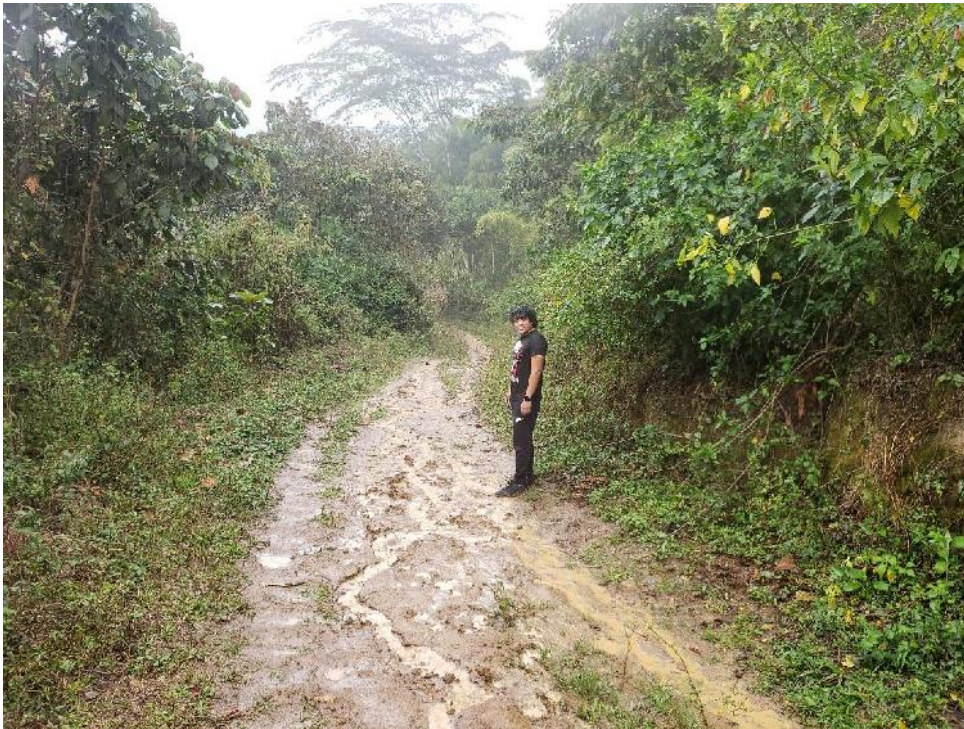
Fotografía N°3.9: Camino en mal estado
