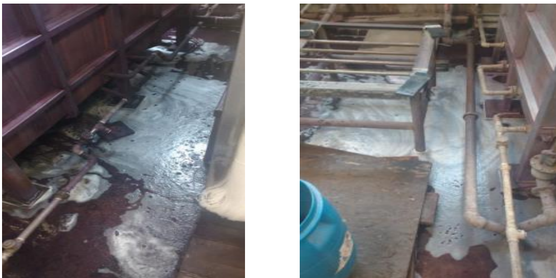
Figura 2. Descarga del agua residual.
