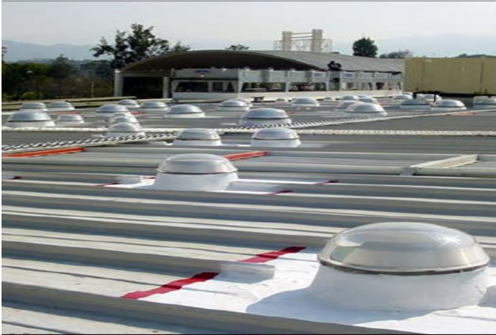
Anexo 07: Sistema day light en área de producción USA, parte superior –techo.
