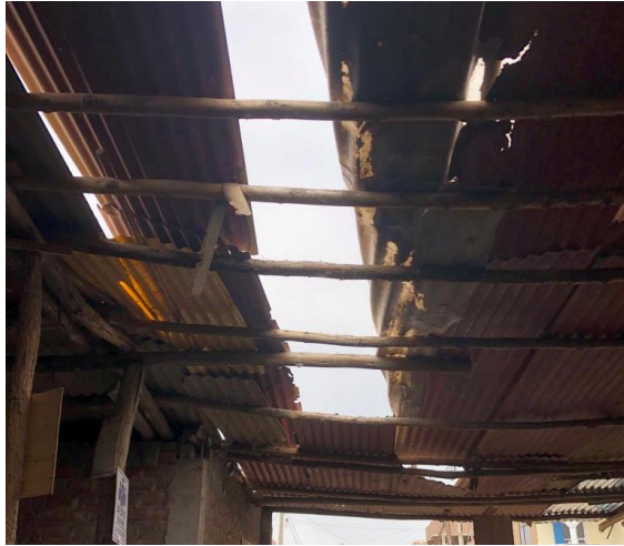
Anexo 34- Interior del mercado El Inca, cobertura en mal estado
