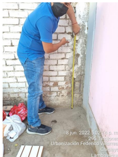
Figura 3. Vivienda N° 3 con eflorescencia - Chiclayo.
