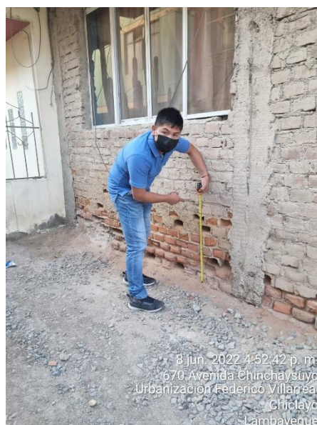
Figura 2. Vivienda N° 2 con eflorescencia - Chiclayo.
