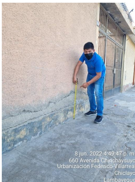
Figura 1. Vivienda N° 1 con eflorescencia - Chiclayo.
