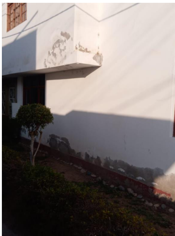
Figura 6. Vivienda N° 6 con eflorescencia - Chiclayo.
