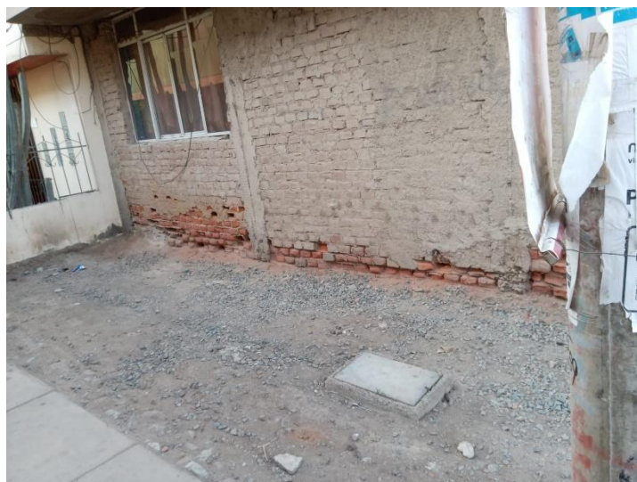
Figura 5. Vivienda N° 5 con eflorescencia - Chiclayo.
