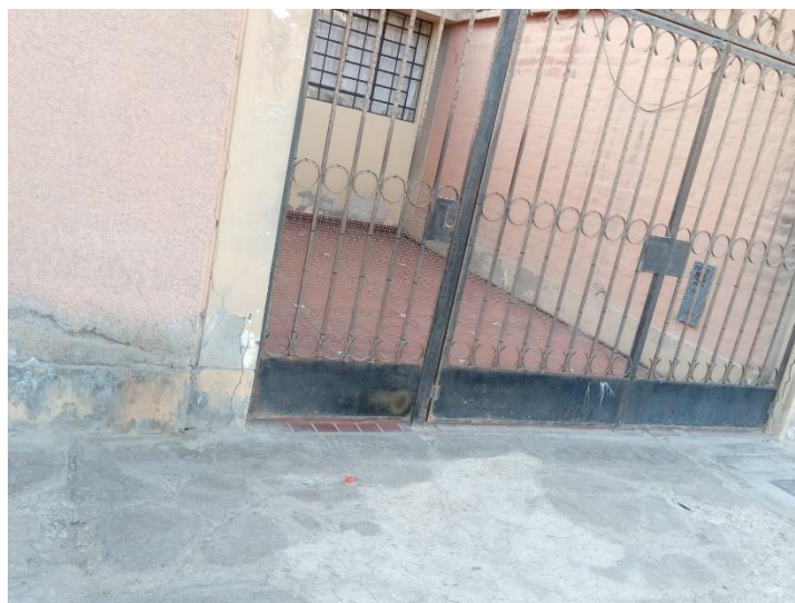
Figura 4. Vivienda N° 4 con eflorescencia - Chiclayo
