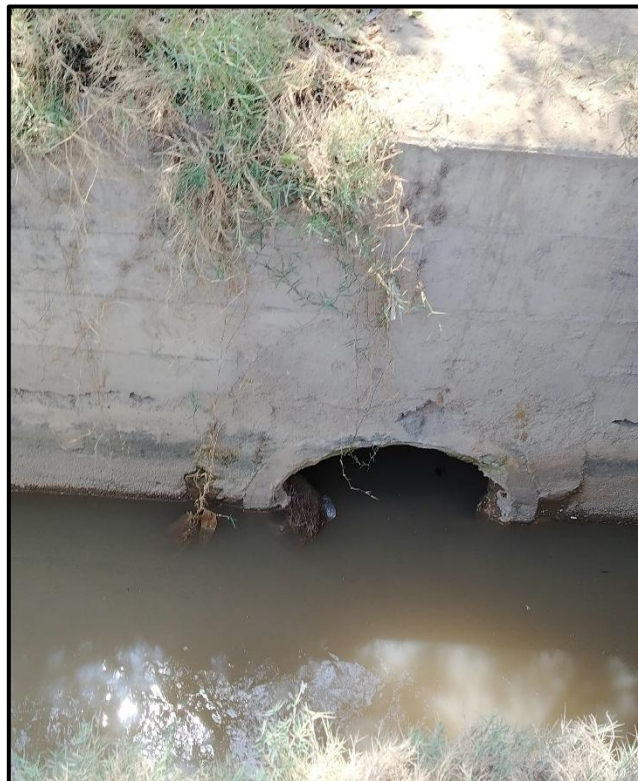
Fig. 81. Presencia de instalaciones ilegales Km 1+643.30
