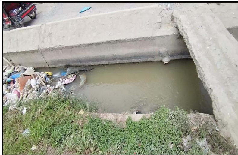
Fig. 88. Más instalaciones ilegales con residuos sólidos Km 3+495.30
