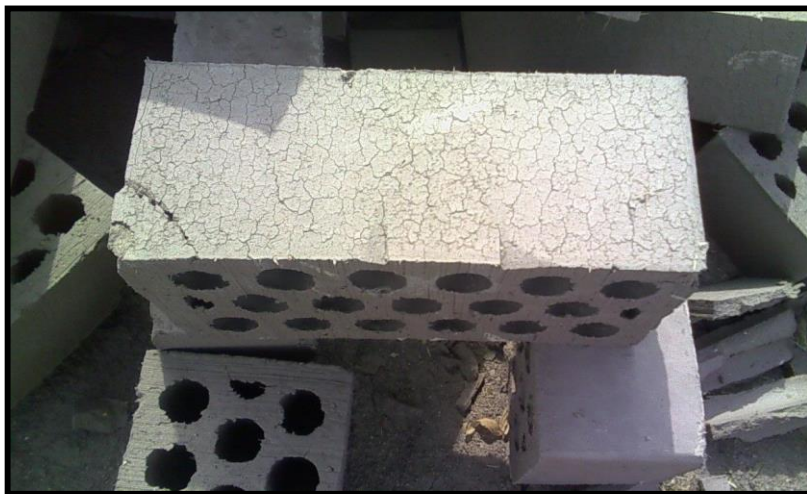
Figura 27: Mermas a causa de las lluvias
