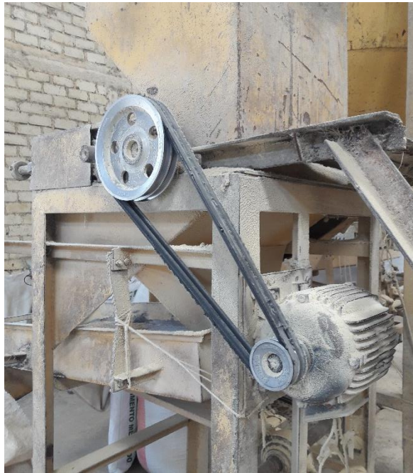
Imagen 01: Falta de guarda de protección para mecanismos de transmisión por faja
