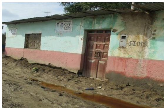
Figura 5.- Vivienda afectada por humedad en la cimentación
