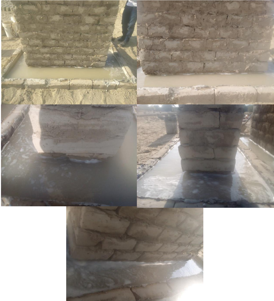
Figura 257.-Muro Tradicional inundado
