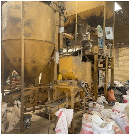
Figura 1: Máquinas sin protección Fuente: ABANOR SAC.
