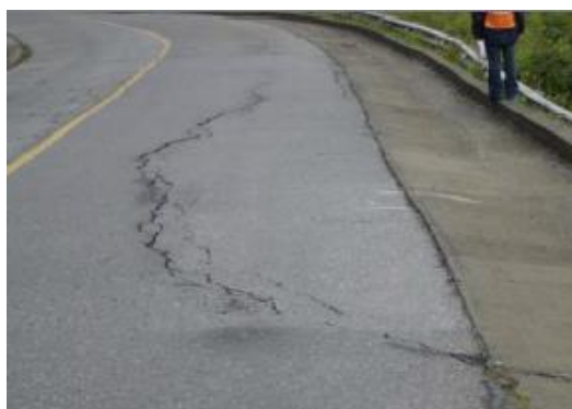
Figura N°20: Grietas de desplazamiento
