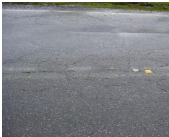
Figura N°04: Grieta de contracción
