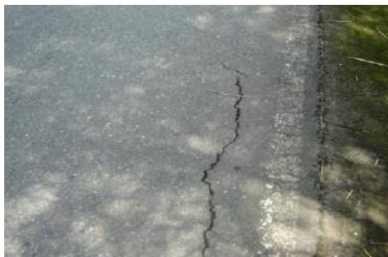
Figura N°09: Grieta de borde
