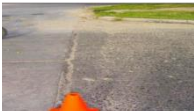
Figura N°19: Deformación por empuje
