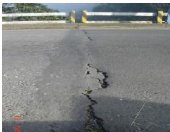
Figura N°10: Grieta de reflexión de junta
