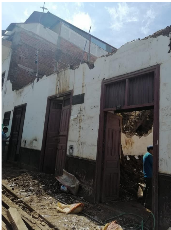
IMAGEN 21. Destrucción de Casona en centro histórico de la ciudad
