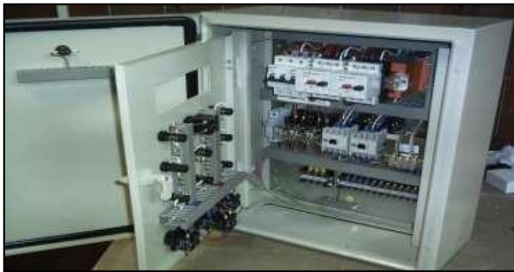
Figura 29: tablero de control.
