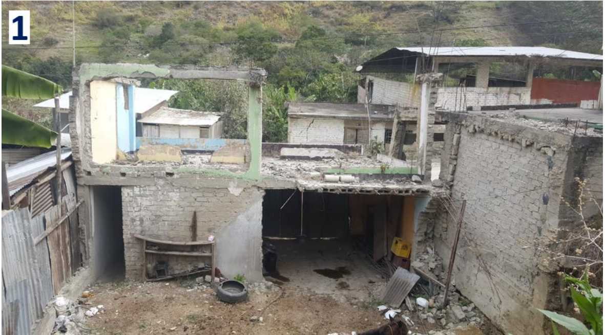
Figura 2: Conjunto de viviendas destruidas Fuente: Propia, 2023.
